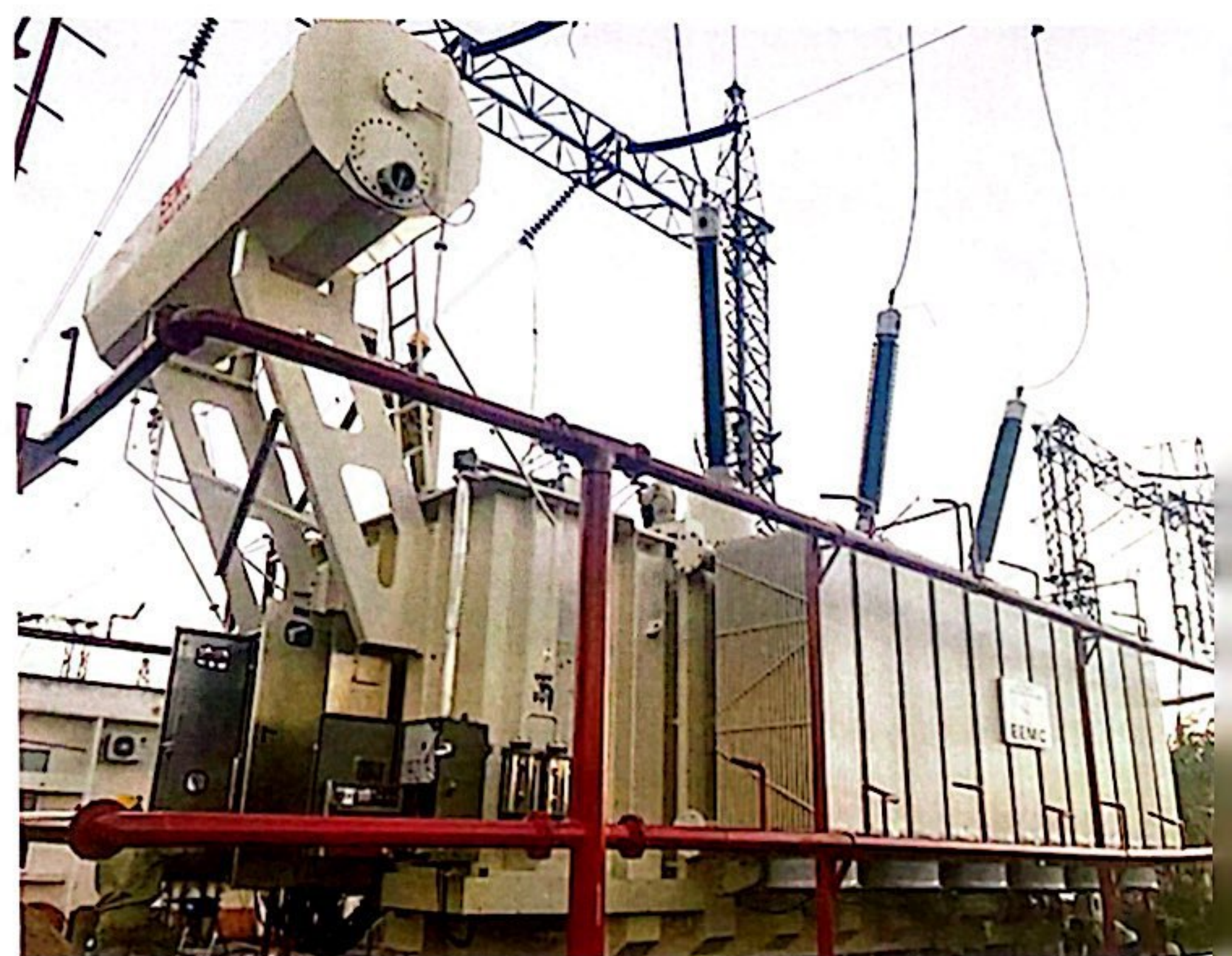
Trạm biến áp 220KV thủy điện Huội Quảng – Mường La – Sơn La
