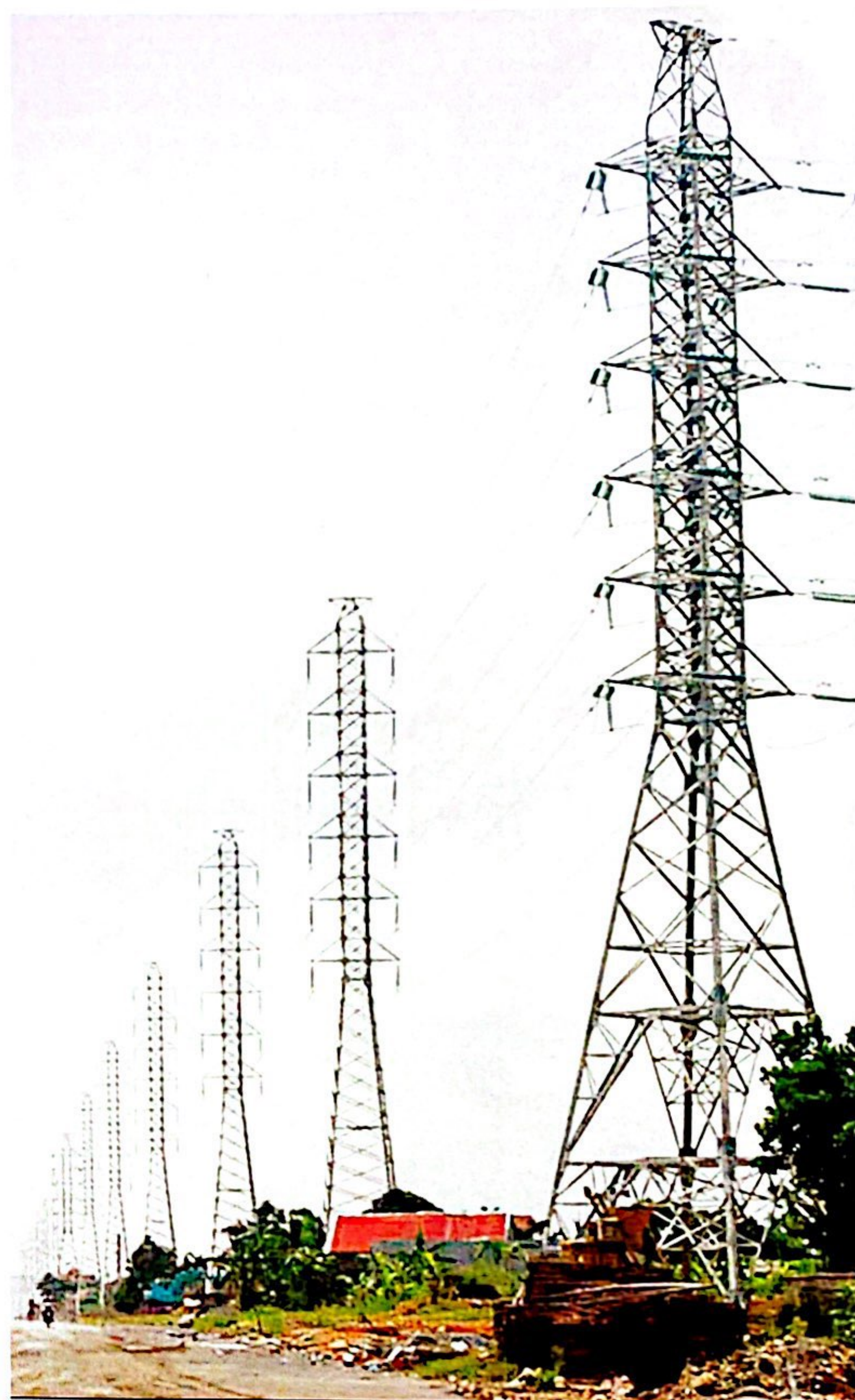
Đường dây 110 KV Ô Môn
